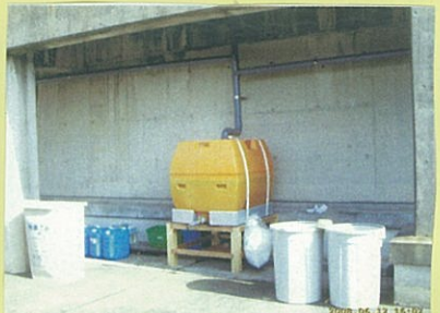
屋上には、雨水タンクを設置。ゴミ箱も、タンクに利用！
